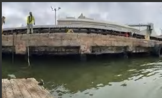
破损的混凝土梁
