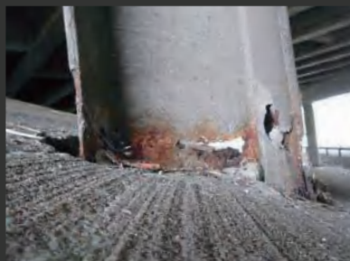
因腐蚀导致腹板截面严重损失的 H 型桩
